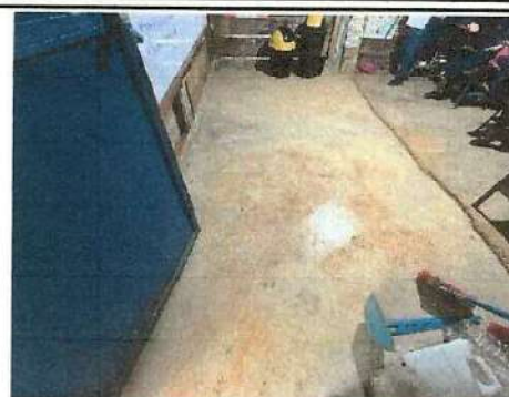
Foto 2: MODULO DE AULAS - Las condiciones del piso estan malas
