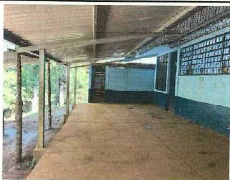
Foto 1: MODULO DE AULAS - Se encuentra en mal estado el cerramiento el aula
