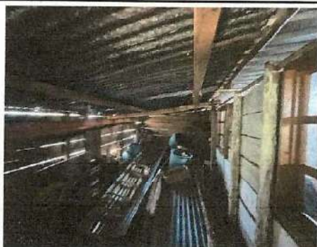
Foto 3: MODULO DE AULAS - El techo del aula esta en mal estado, hay filtraciones
